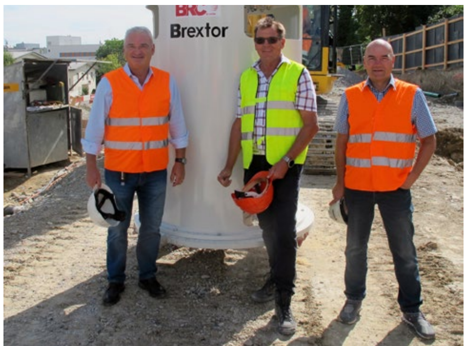
Die Firma Aregger hat das Gerät in Opfikon erstmals im Einsatz. Bild: Unternehmer Hans Aregger, Brextor-Erfinder Alois Portmann und Urs Odermatt, Leiter Tiefbau Aregger (v.l.).
