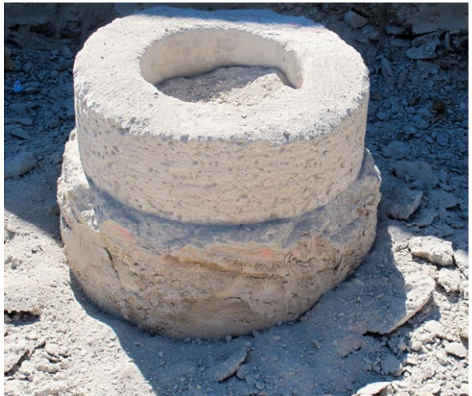
Das Resultat nach der zweiten Phase der Pfahlkopfbearbeitung ist ein Hohlzylinder, in dem sich noch die Bewehrungseisen befinden. Diese werden anschliessend freigelegt.
